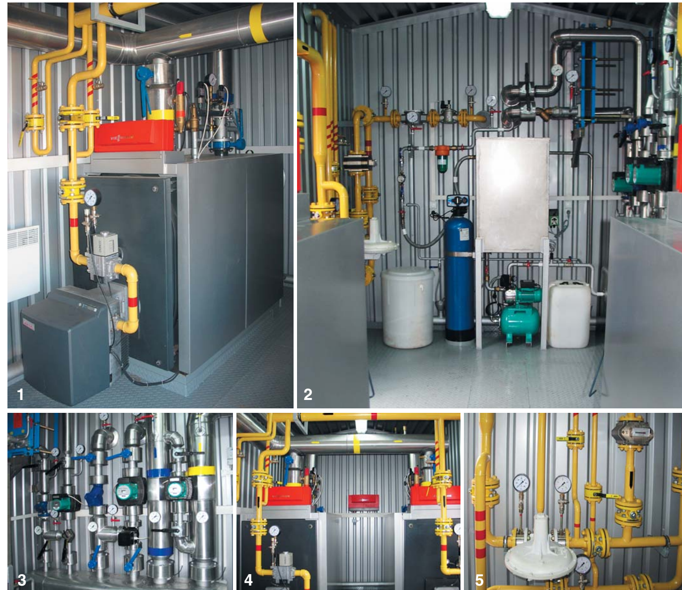
1 – котел водогрійний Vitorplex 100 PV1 з газовим паливом; 2 – установка водопідготовки, бак запасу хімічно очищеної води, станція підживлення, теплообмінник нагріву гарячої води, ввід газу; 3 – розподільчий колектор з контурами опалення і нагріву гарячої води, циркуляційні насоси та регулюючі триходові клапани контурів; 4 – компоновка котлів у приміщенні котельні, регулятор для керування котлами залежно від зовнішньої температури; 5 – вузол обліку газу з регулятором середнього тиску.
