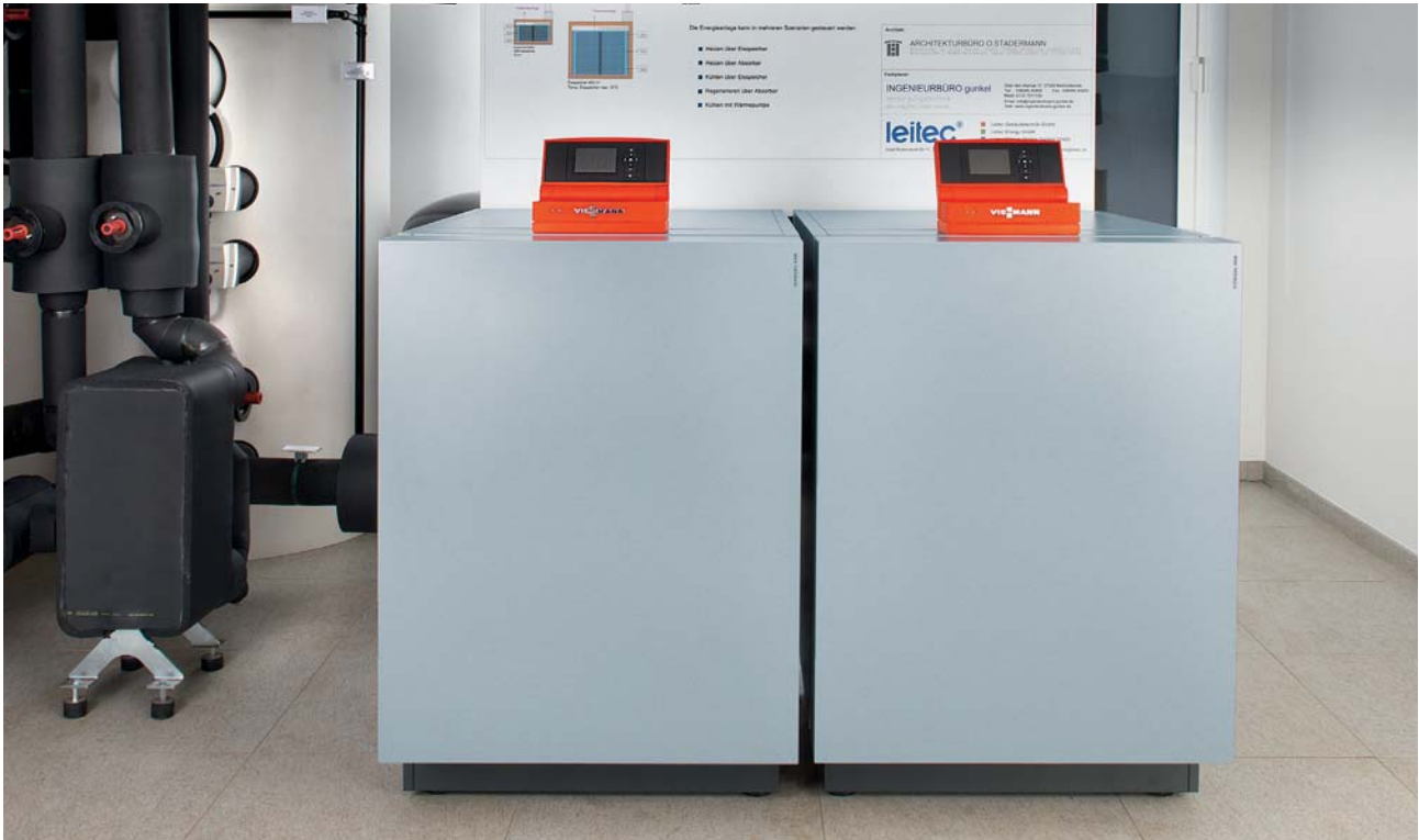
Zwei Sole/Wasser-Wärmepumpen Vitocal 300-G mit einer Gesamtleistung von 64 kW.
