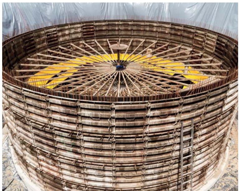
Die Abmessungen des Eisspeichers werden nach der jeweiligen Leistung individuell berechnet.
