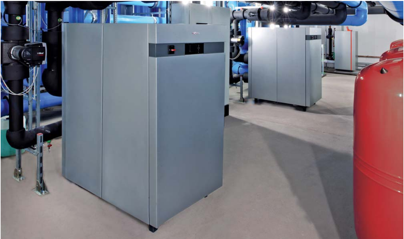
Zwei Wärmepumpen Vitocal 300-G Pro mit je 120 kW Leistung, im Hintergrund ein Gas-Brennwert-Spitzenlastkessel Vitocrossal 300.
