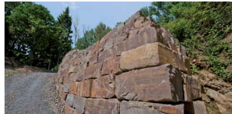
Hinter der mächtigen Natursteinmauer verbirgt sich der 1700 m 3 große Eisspeicher.
