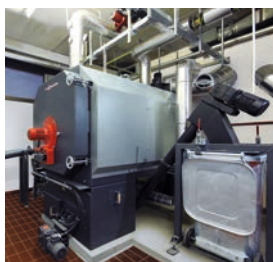
Академія бізнесу, м. Лустенау, Австрія – котел Vitoflex 300-RF номінальною тепловою потужністю 220 кВт
